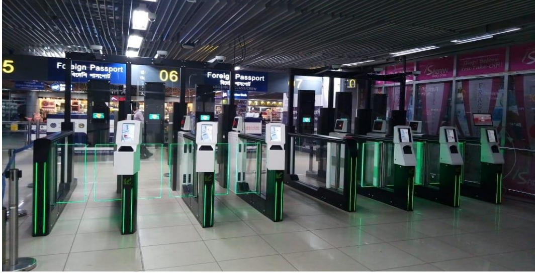
হযরত শাহজালাল আন্তর্জাতিক বিমানবন্দরে স্থাপিত ই-গেইট স্থাপন
