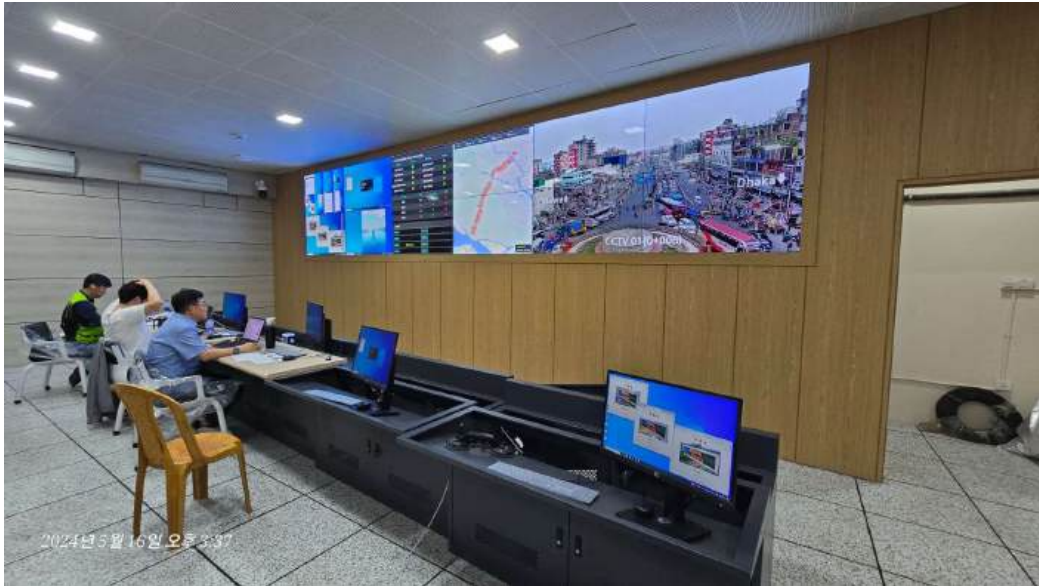
প্রকল্পের আওতায় সড়ক ভবনে স্থাপিত Traffic Management Center (TMC)
