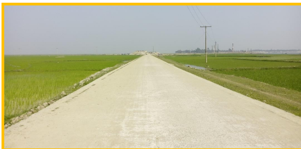
উজানচর-বাজিতপুর-অষ্টগ্রাম মহাসড়কের সাবমার্জিবল অংশ
