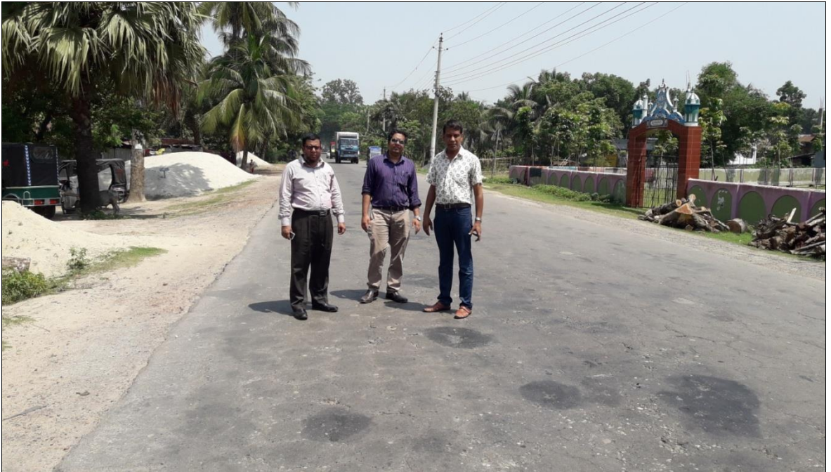
মনিটরিং প্রধান জনাব দীপঙ্কর মন্ডল কর্তৃক ঝিনাইদহ বাস টার্মিনাল-আরাপপুর ইন্টার সেকশন-আলহেরা বাসস্ট্যান্ড মহাসড়কের সারফেস ক্র্যাক পরিদর্শন
