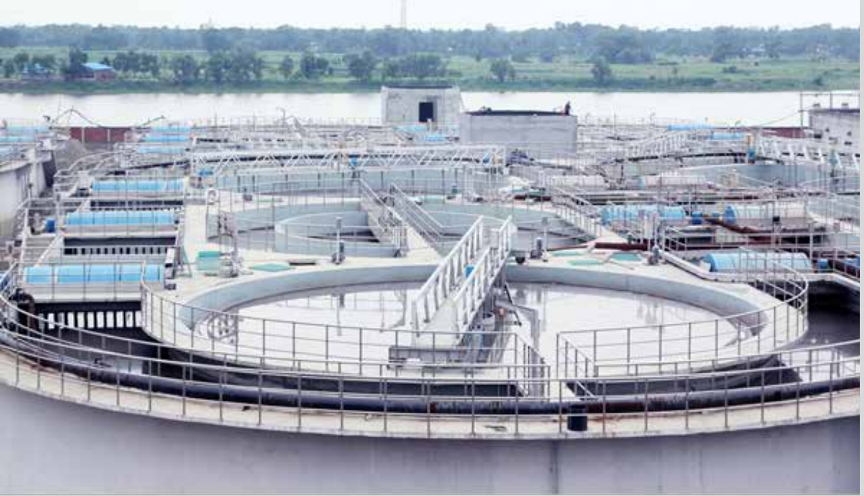
চিত্র: Common Effluent Treatment Plant (CETP)
