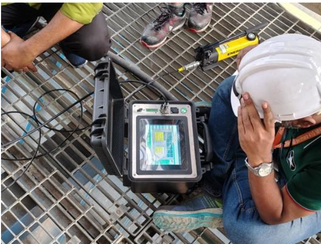
চিত্র-২.১ : Safety valve সমূহের Pop-Up Test.
