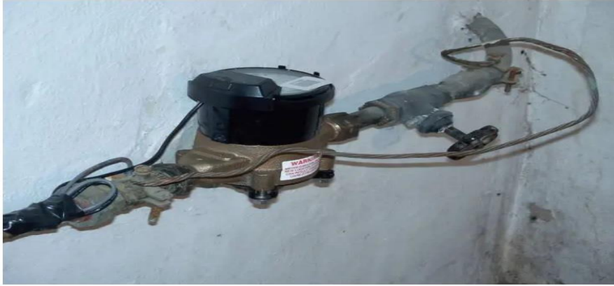
চিত্র ১০: একটি গ্রাউন্ডিং কন্ডাক্টর একটি জল মিটারকে বাইপাস করে
