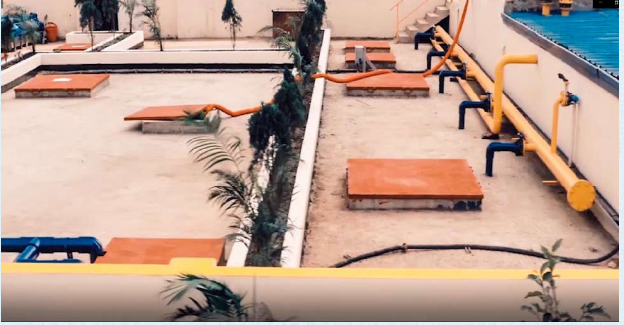
চিত্র: স্বপ্ননগর-১ আবাসিক ফ্ল্যাট প্রকল্পে আধুনিক বর্জ্য ও পানি পরিশোধনাগার (STP & WTP) নির্মাণ করা হয়েছে।
