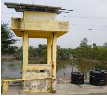
চিত্র-১: Pond Sand Filter
