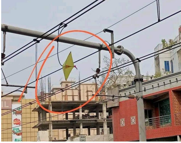
Metro Rail এর উচ্চ ক্ষমতা সম্পন্ন Overhead Catenary System এর উপর জড়িয়ে থাকা ঘুড়ি
