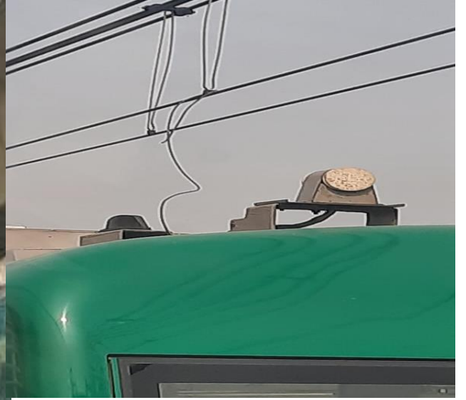
Metro Rail এর উচ্চ ক্ষমতা সম্পন্ন Catenary System এর উপর রুট এ্যালাইনমেন্ট বসবাসকারীগণ কর্তৃক ছুড়ে ফেলা ক্যাবল
