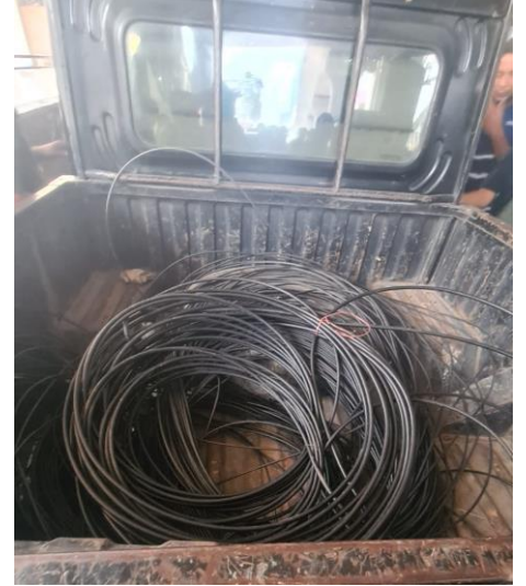
Metro Rail এর উচ্চ ক্ষমতা সম্পন্ন Catenary System এর উপর দিয়ে নেয়া ডিস এবং ইন্টারনেট লাইনের ক্যাবল অপসারণ
