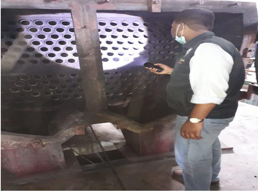
চট্টগ্রাম কার্যালয়ের অধীন বয়লার পরিদর্শন
