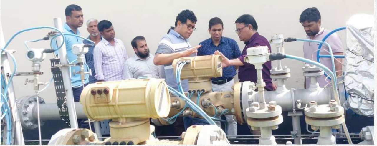
। ব্যবস্থাপনা পরিচালক মহোদয়সহ মিডল্যান্ড ৫১ মেগাঃ পাওয়ার প্লান্টের আন্ডারস্ট্যান্ডিং মিটার পরিদর্শন
