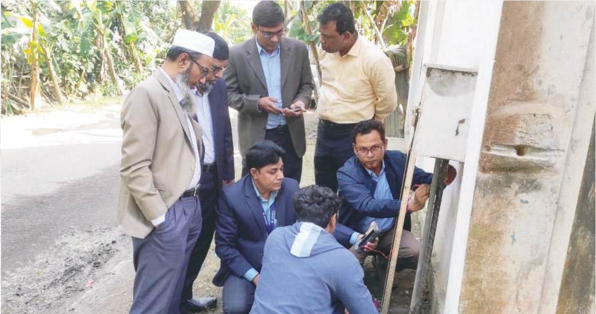
। বসুরহাট এলাকায় পরিচালক (পরিকল্পনা), পেট্রোবাংলা এর উপস্থিতিতে পাইপলাইনের Pipe to Soil Potential (PSP) রিডিং গ্রহণ
