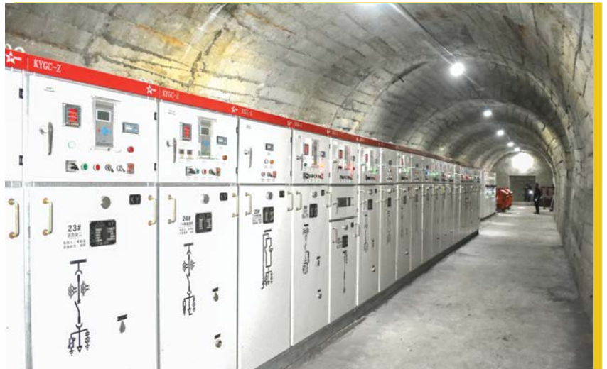
বিসিএমসিএল এর নবনির্মিত ভূ-গর্ভস্থ সাবস্টেশন
