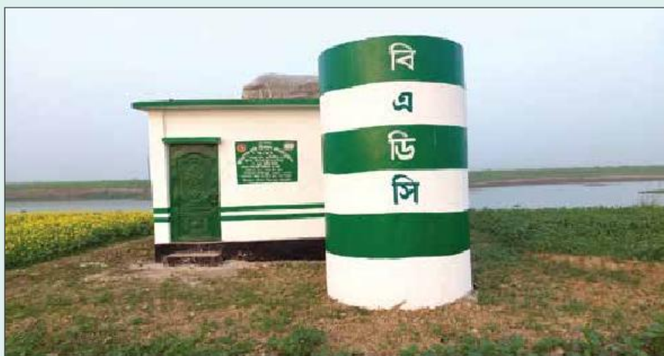
পাবনা জেলার ফরিদপুর উপজেলায় স্থাপিত ৫-কিউসেক এলএলপি সেচ স্কিম
