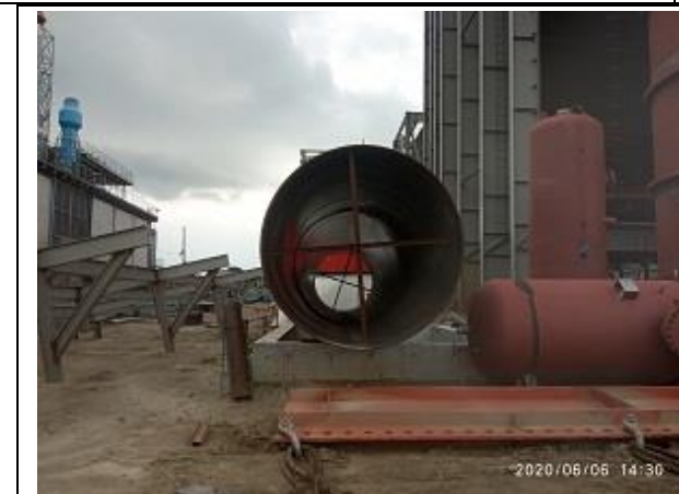
Fig: Water Discharge Pipe
