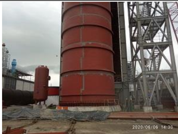
Fig: HRSG blown cooling water pool
