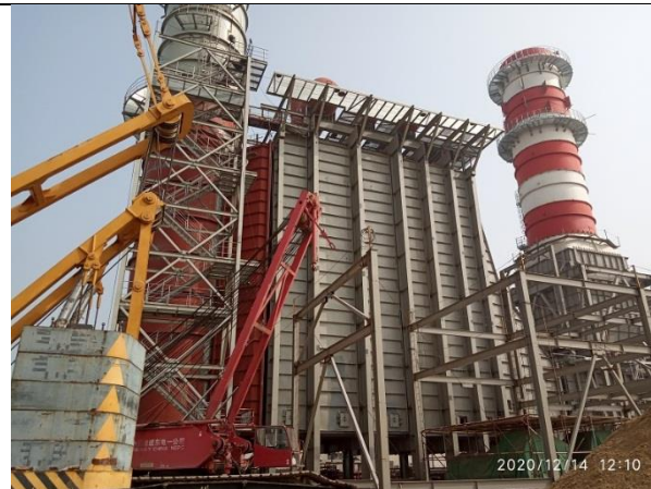
Superstructure of HRSG and Exhaust Stack
