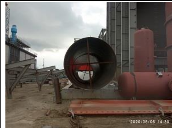
Fig: Water Discharge Pipe
